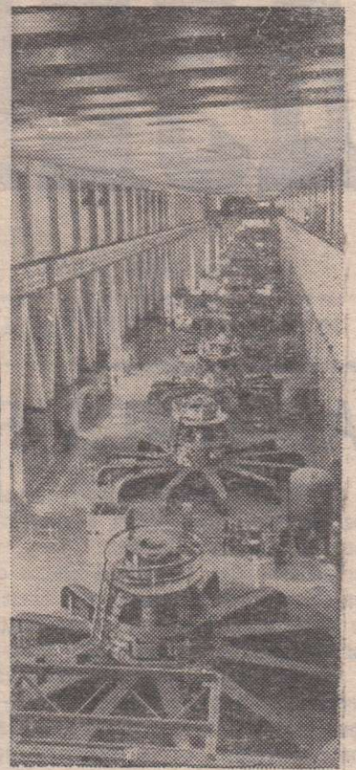
Братская ГЭС. Машинный зал.
